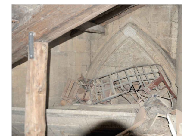
FORJADO MAL ESTADO QUE ACOMETE CONTRA CABECERA
