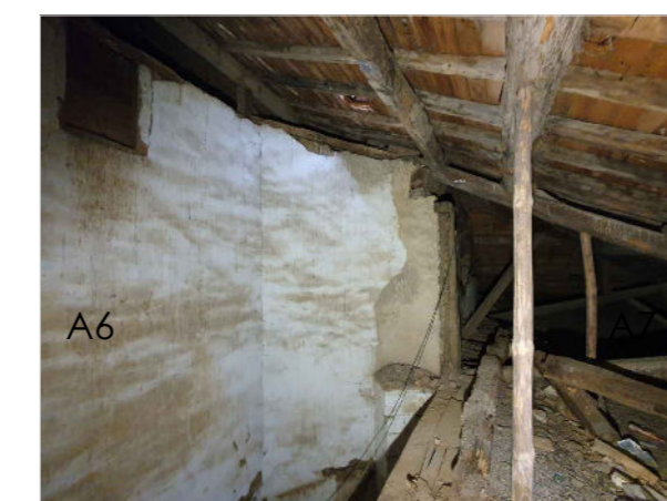
CAJA ESCALERA Y FORJADO A PUNTO COLAPSO
